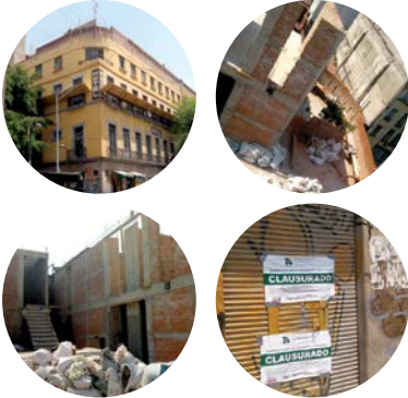
Motolinía 40 , Centro, Cuauhtémoc: clausura de actividades de ampliación y demolición en inmueble catalogado.
