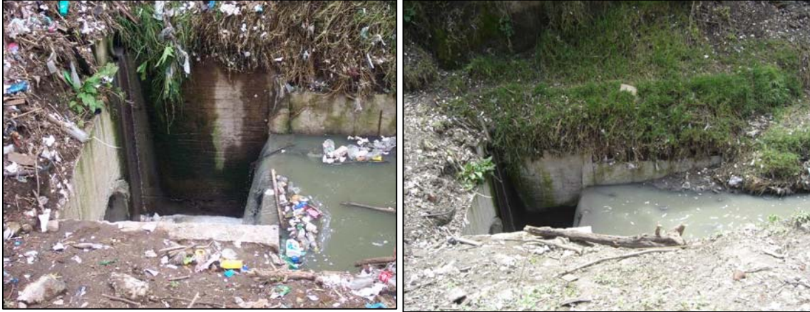
Figura 6.- Colector de aguas residuales
