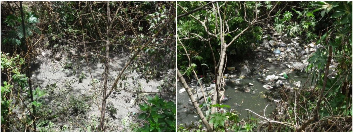
Figura 13.- Se muestran la acumulación de residuos en el interior del canal.
